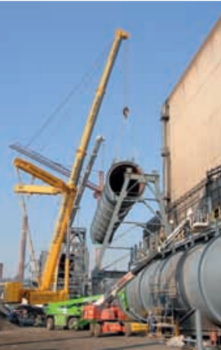
La protection contre les fumées, un thème prioritaire : la nouvelle installation de dépoussiérage secondaire dans l'aciérie
