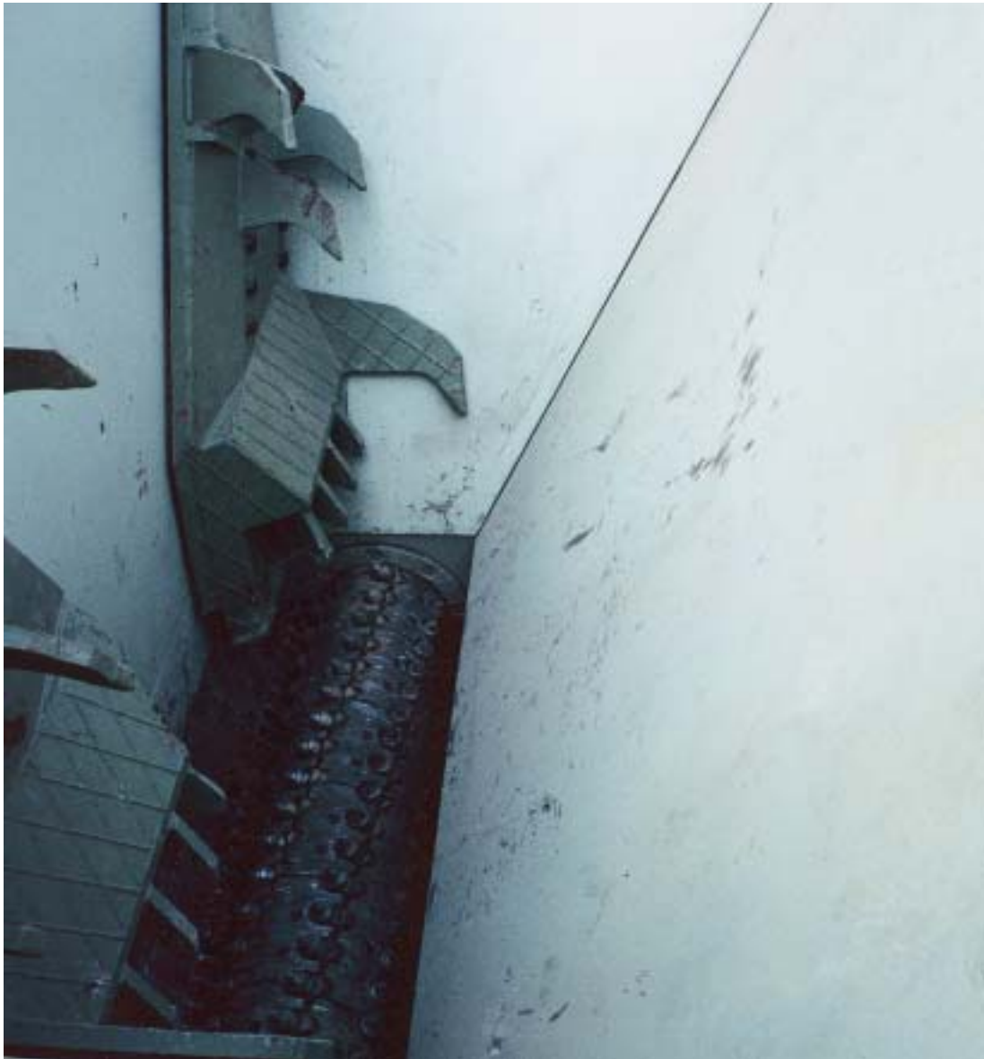
Figure 6 : Trémie d'alimentation d'une installation de broyage, parois en DILLIDUR 400 V
