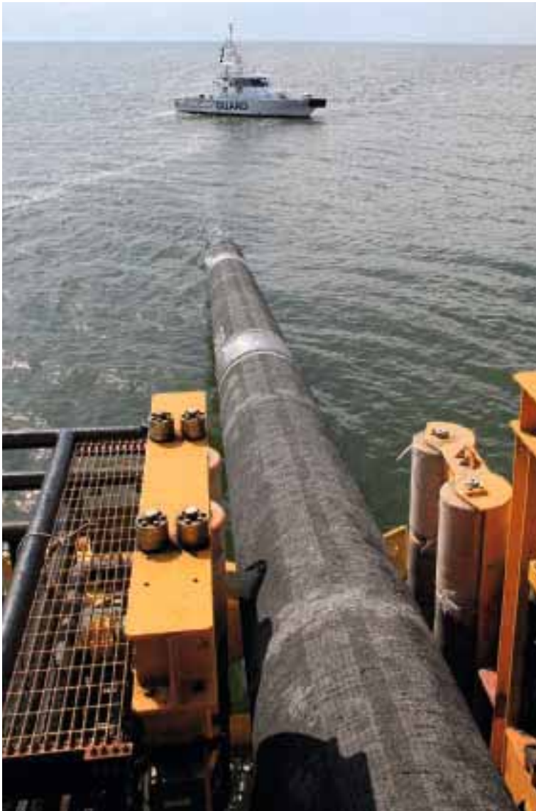
Offshore-Verlegung der EUROPIPE-Großrohre für die Nord-Stream-Pipeline (Foto mit freundlicher Genehmigung der Nord Stream AG)
