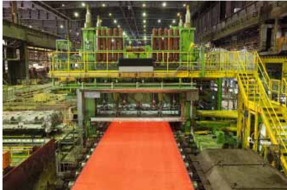
Die neue Warmblech-Richtmaschine sorgt für die notwendige Ebenheit der Bleche.
